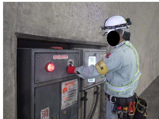
道路トンネル非常用装置点検
