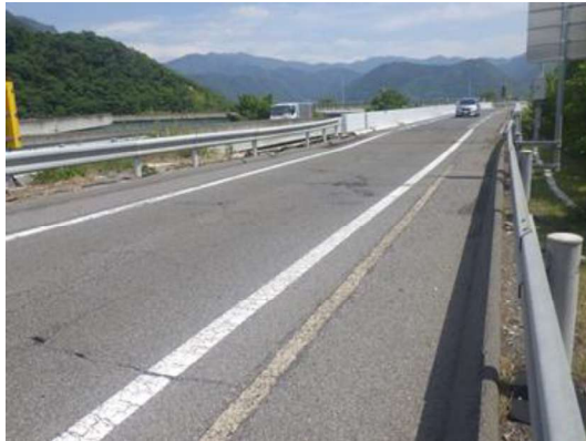
舗装損傷状況
